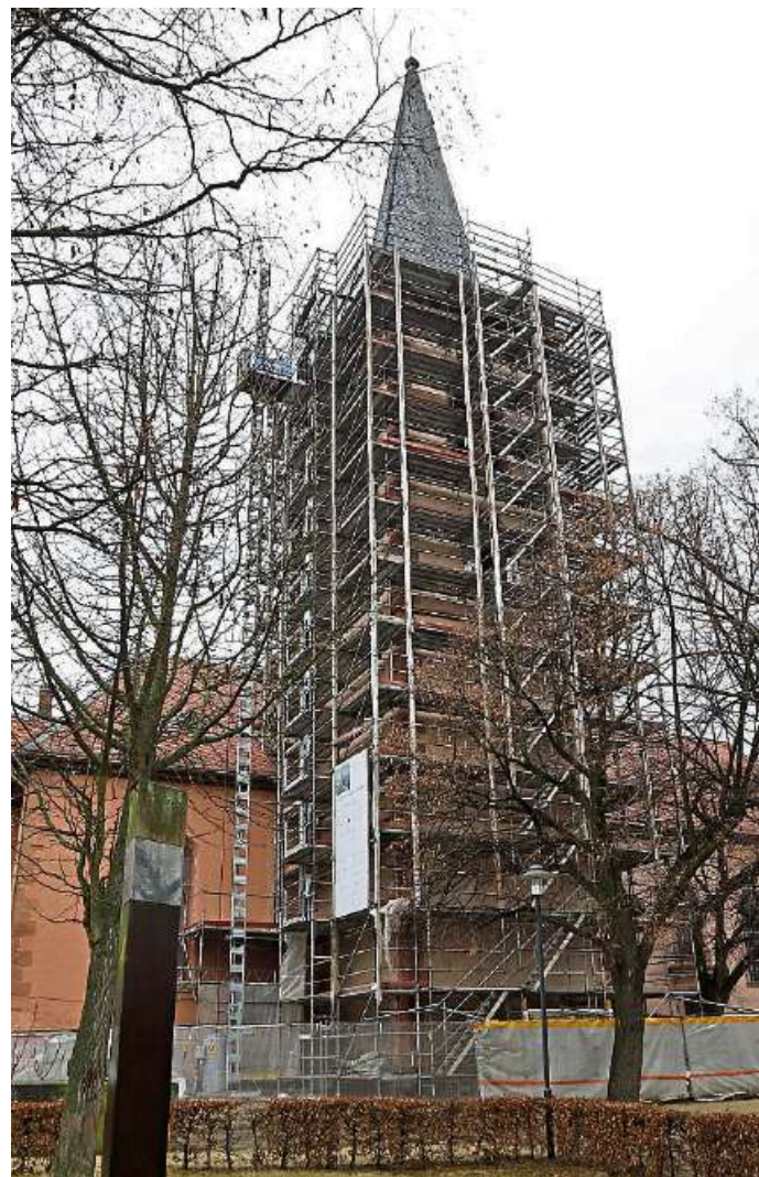
Der Kirchturm präsentiert sich nach drei Jahren wieder ohne Plane. Das Gerüst soll als Nächstes abgebaut werden. Foto: pa/Dirigo
